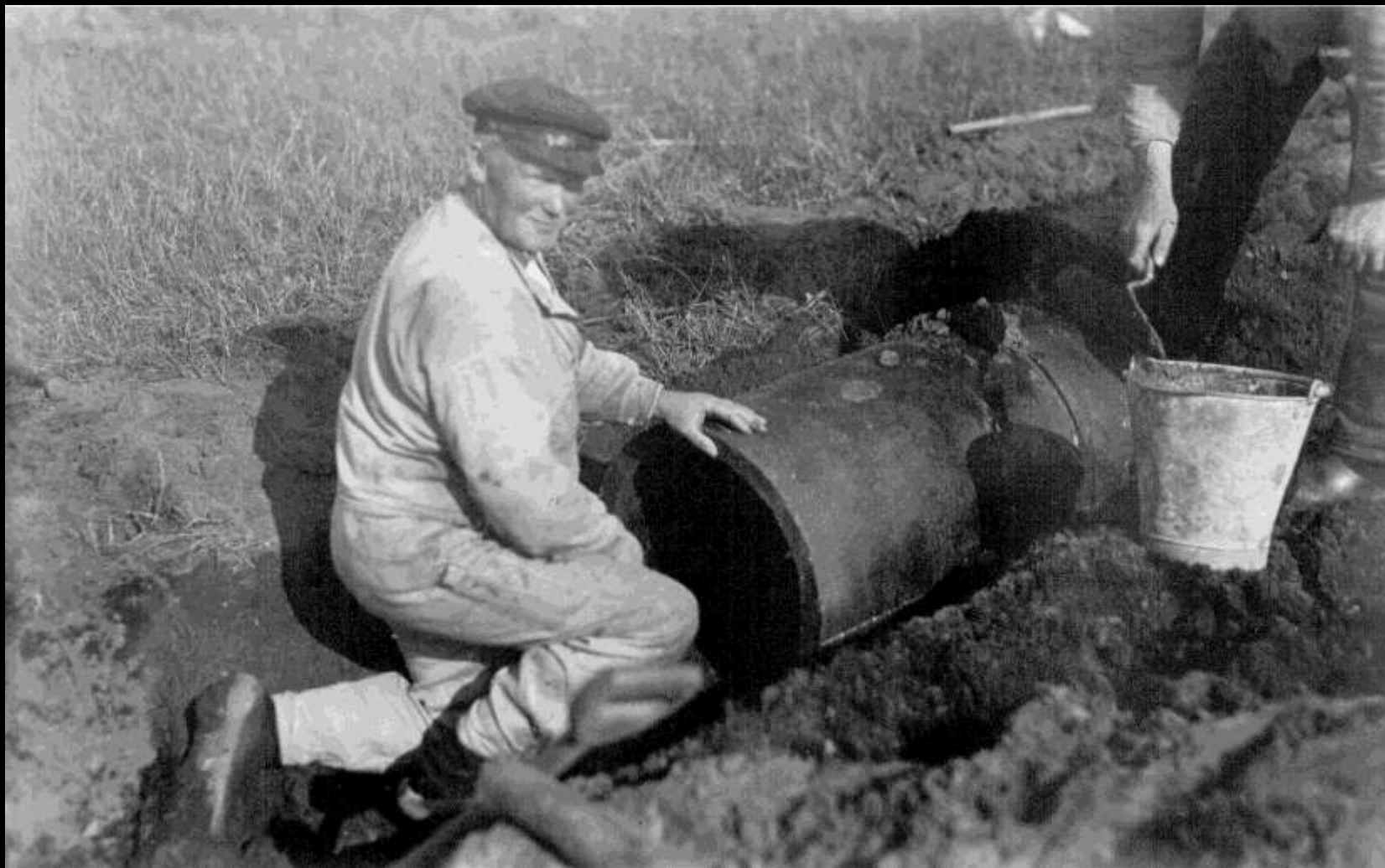
Cementstøber Müller er ved at lægge de sidste rør, som skal lede vandet fra Plagborgkanalen ud i det mægtige bassin.
